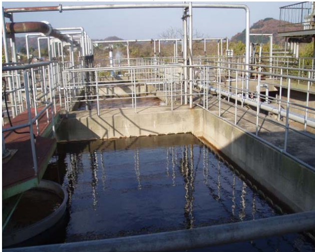
汚水処理設備と汚泥脱水機
