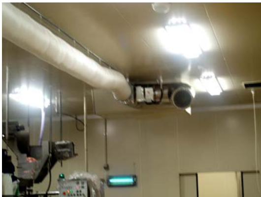
ダクト付き空調
