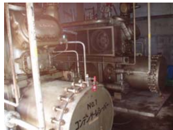
冷凍機 (59.9t/日)
