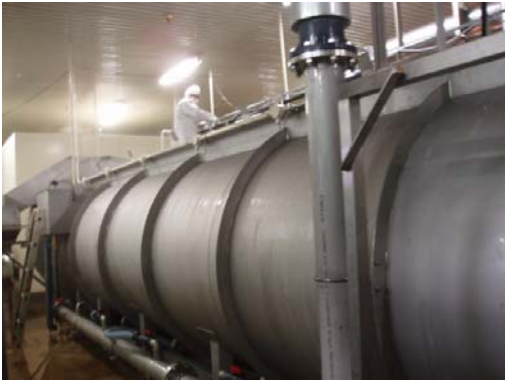
中抜きチラー槽 4℃以下の冷却水により 35 分間洗浄冷却
